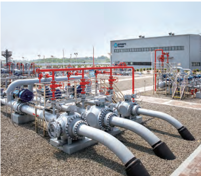
集團位於江蘇省常州市金壇區的地下儲氣庫，不斷提升運營氣量及調峰能力。
